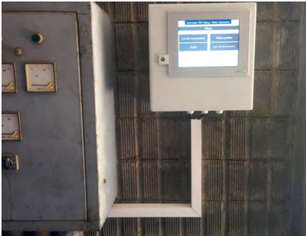
Projekt 1: Schaltschrank mit Smartmeter
